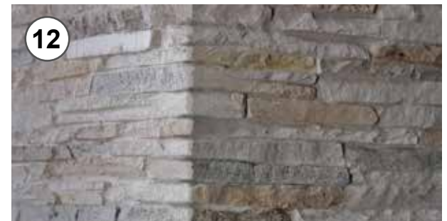
12 - L'angolo pronto per la colorazione con gli ossidi da effettuare a completa asciugatura dello stucco 12 - The corner ready for the colored oxides to be made to complete drying of the glue
