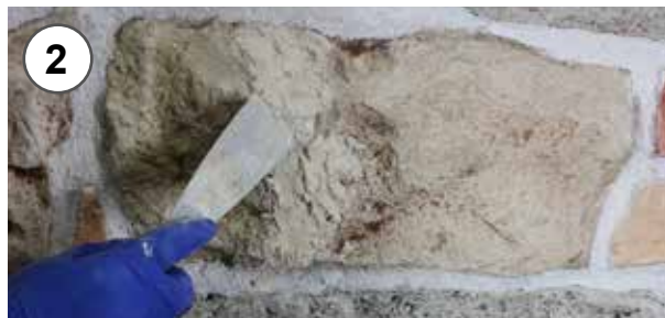
2- Applicazione dello stucco mediante spatola 2 - Application of the glue on the wall
