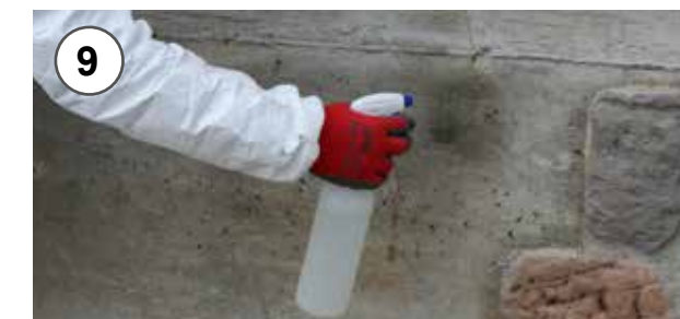
9 - Acqua nebulizzata sul muro per migliorare la presa 9 - Water spray on the wall to improve grip
