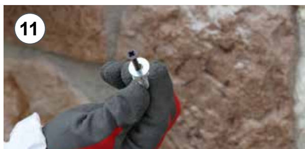
11 - Fissaggio provvisorio del pannello con viti e rondelle sino a presa della schiuma 11 - Temporary fastening of the panel by screws and washers until the foam grip
