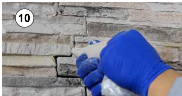
10 - Riempimento giunto con apposito stucco mediante "sac à poche" 10 - Fill joint with a filler using pastry bag
